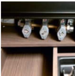
Gut erreichbare Gasabsperrehähne hinter der obersten Schubladenblende.
